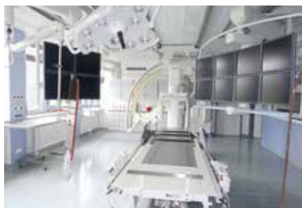
Anlage vor Inbetriebnahme
